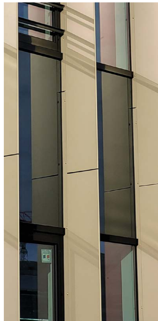
Héliat, Val de Fontenay - Maître d'œuvre : DLM ARCHITECTES - Maître d'ouvrage : GROUPE GIBOIRE ET GROUPE ARC - Mise en œuvre : ALU RENNAIS (65) / SOFRADI (44)
